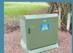
Nouveau poste de transformation installé route du Theil
